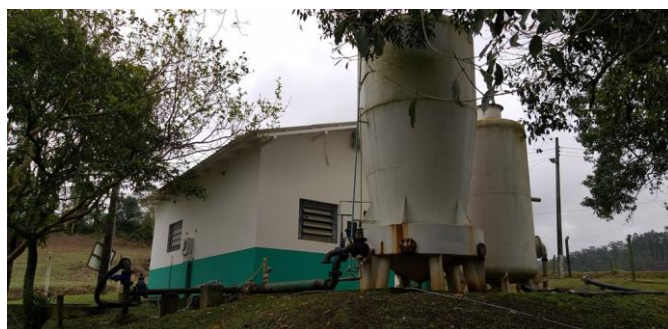
Figura 29 – ETA (vista posterior) – Floculador/decantador e Filtro.
