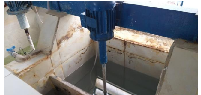
Figura 35 – ETA: misturadores de cloro e flúor.
