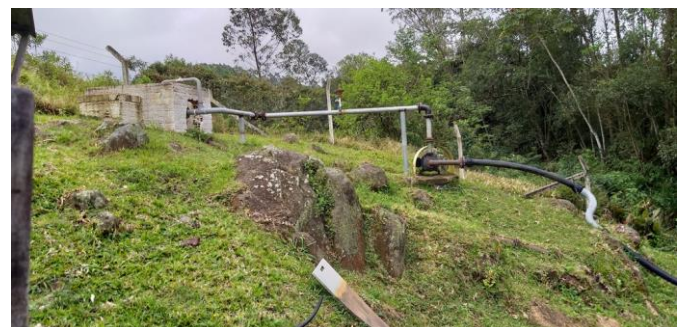
Figura 12 - Barragem 1: Linhas de sucção e recalque
