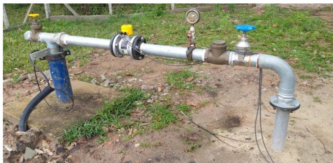
Figura 22 – Cavalete de saída do poço.
