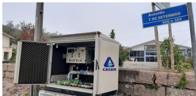
Figura 43 – Booster – rua 7 de setembro: abrigo e bombas.
