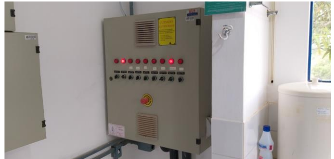
Figura 33 – ETA: quadro de comando – acionamento bombas poço – telemetria.
