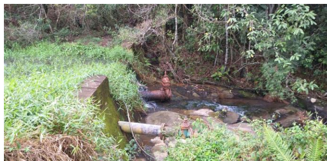
Figura 15 - Barragem 2: descarregador de fundo e saída da adução de água
