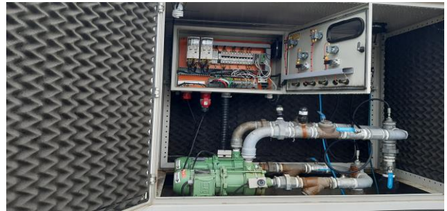
Figura 45 – Booster – rua 7 de setembro: quadro de comando elétrico bombas.
