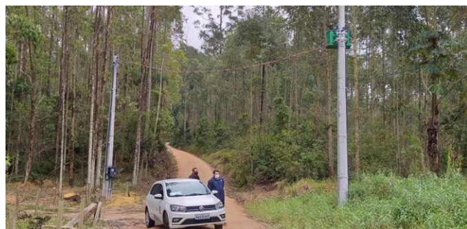
Figura 26 – Transformador (direita) e medidor de energia elétrica (esquerda).
