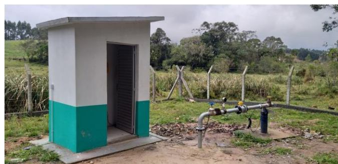
Figura 20 – Abrigo do quadro de comando elétrico.
