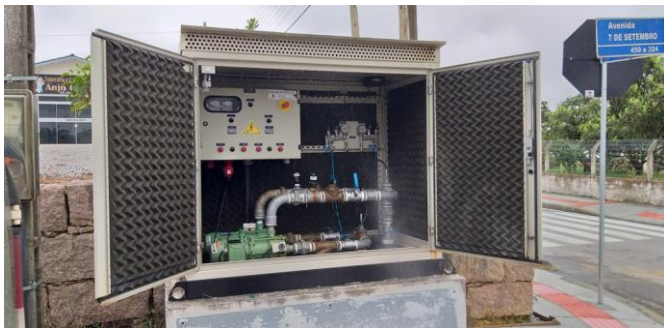
Figura 46 – Booster – rua 7 de setembro: quadro de comando elétrico bombas.
