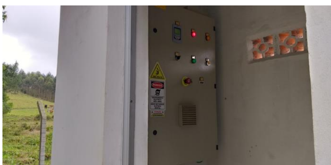
Figura 25 – Quadro de Comando elétrico.
