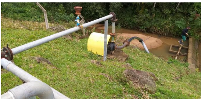
Figura 11 - Barragem 1: Linhas de sucção e recalque
