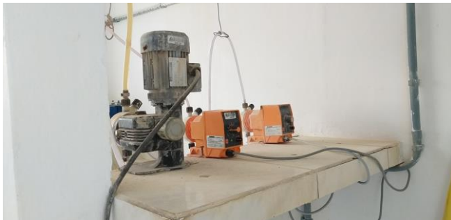
Figura 34 – ETA: bombas dosadoras
