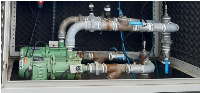
Figura 44 – Booster – rua 7 de setembro: bombas.
