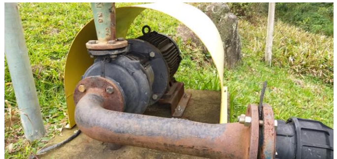
Figura 10 - Barragem 1: Bomba de recalque de água bruta
