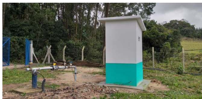
Figura 21 – Abrigo do quadro de comando elétrico.
